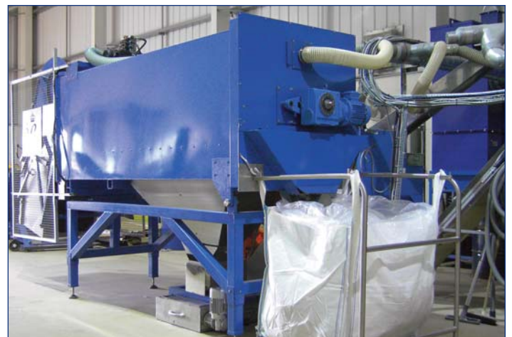
On voit ici l'extrémité finale de l'un des deux séparateurs, au niveau de laquelle les composants en métal et en plastique sont déchargés et collectés. Deux séparateurs sont utilisés en parallèle.
